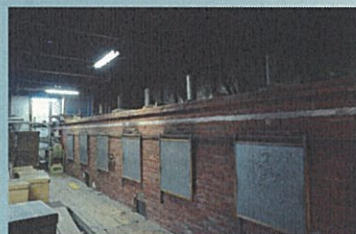
④ 茶工場の煉瓦造乾燥炉
